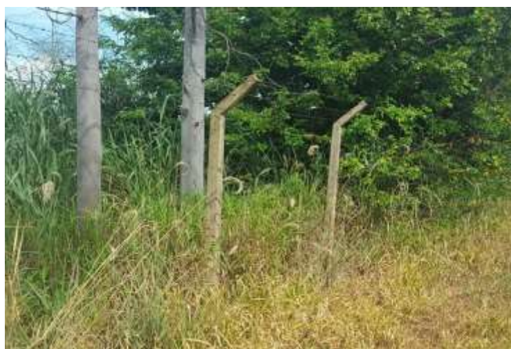
Figura 1. Ausência de isolamento físico
