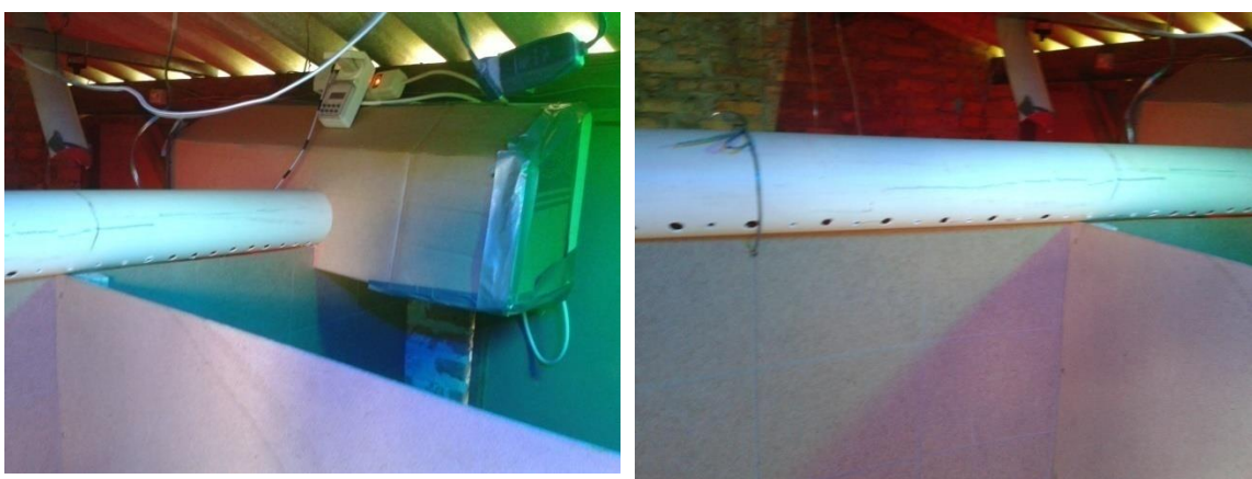
Figura 5. Ar condicionado e sistema de climatização.
