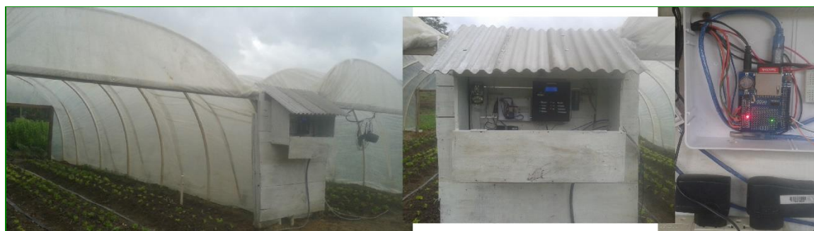
Figura 3: Montagem e instalação do sistema Arduino Datalogger em duas casas de vegetação para coleta de dados microambientais no estrato da cultura vegetal.
